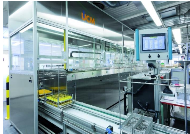
Für die Produktionsendreinigung der unterschiedlichen Teile sind 16 Programme in der Anlagensteuerung hinterlegt.
